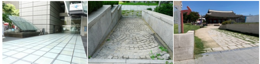
지양: 우천 시 노면이 미끄러운 마감재 지양: 요철 및 굴곡이 심한 마감재 지양: 이음매가 벌어진 마감재
