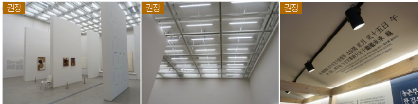
권장: 균일한 조도를 확보하면서 눈부심을 방지한 조명 설치
